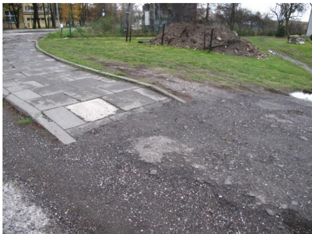
Rysunek 11. Stan chodników na terenie sołectwa Przeżginia
